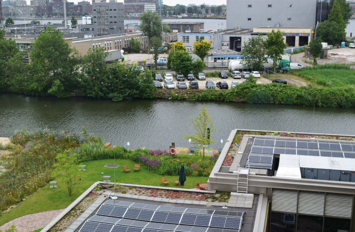
Fotografia 13. Dach z panelami fotowoltaicznymi (w tle obiekty produkcyjne)
